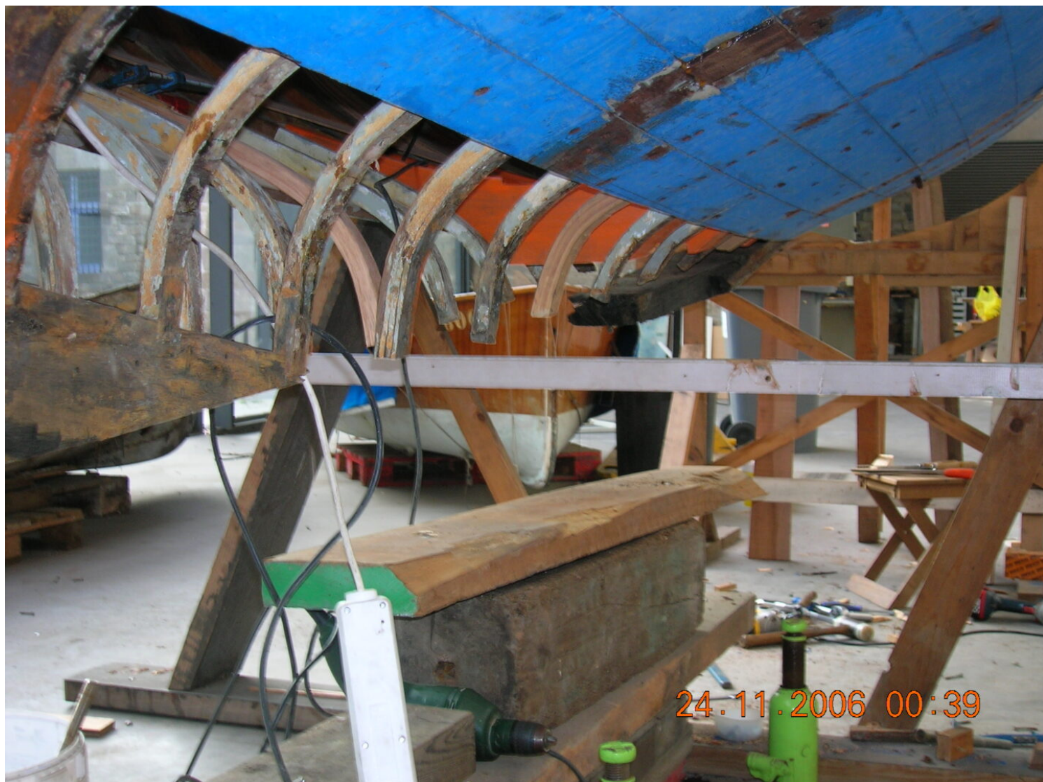
La restauració del Drac va exigir la reconstrucció completa de la quilla. Foto: MMB.
